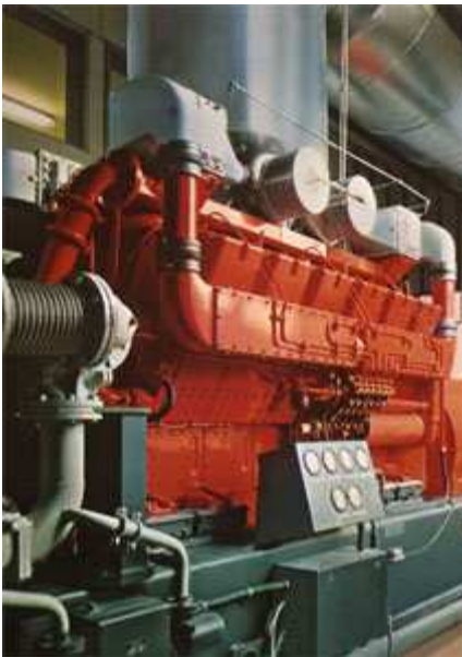
Notstromanlage des Kasseler Klinikums, ein Aggregat von 2,5 MN mit HENSCHEL DIESELMOTOR 12V2423
